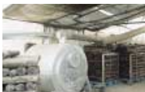
寒さの厳しい1月。廃棄処分する原木を燃料にしたストーブでハウス内を暖めます。
